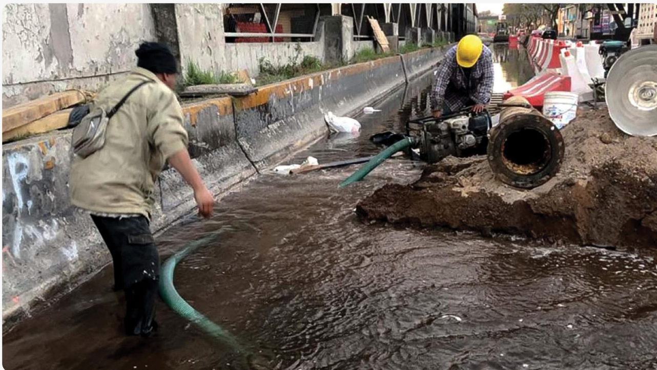
Figura 31. Fugas en el Valle de México.
